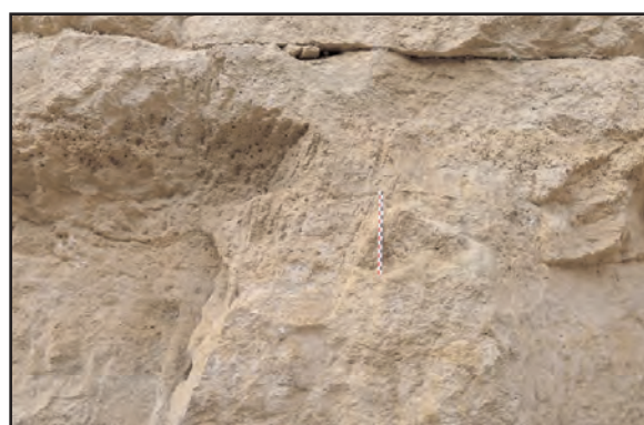
Fig.70 : refouillement horizontal : traces de pic
