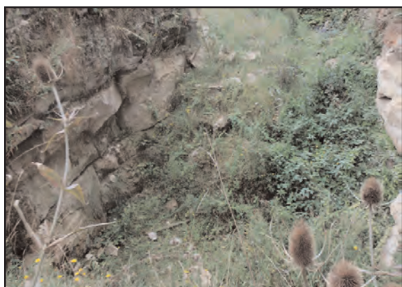
Fig.53 fond de fossé envahi par la végétation
