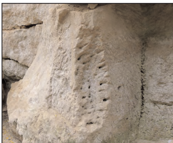
Fig 75 :. Refouillement vertical atypique dans une tranche de défermage semi -souterraine
