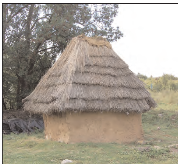
Fig. 24 : toiture dégradée de la cabane
